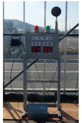
騒音振動大型表示器
